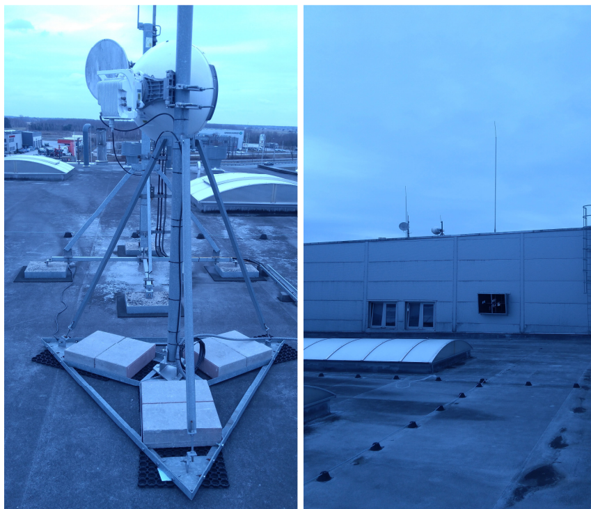
Widok obiektu wraz z zainstalowanym zespołem antenowym
